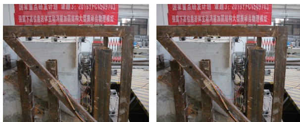
图 13 崩塌危岩体变形图
