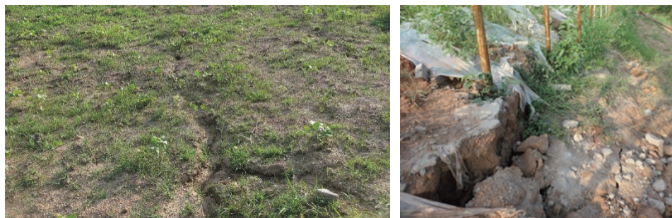
图 3 洞口段地表裂缝
