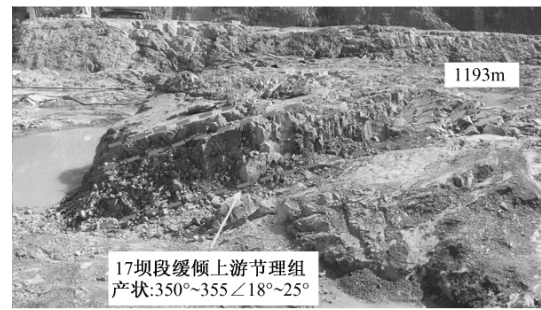
图 4 坝段缓倾上游结构面典型照片
